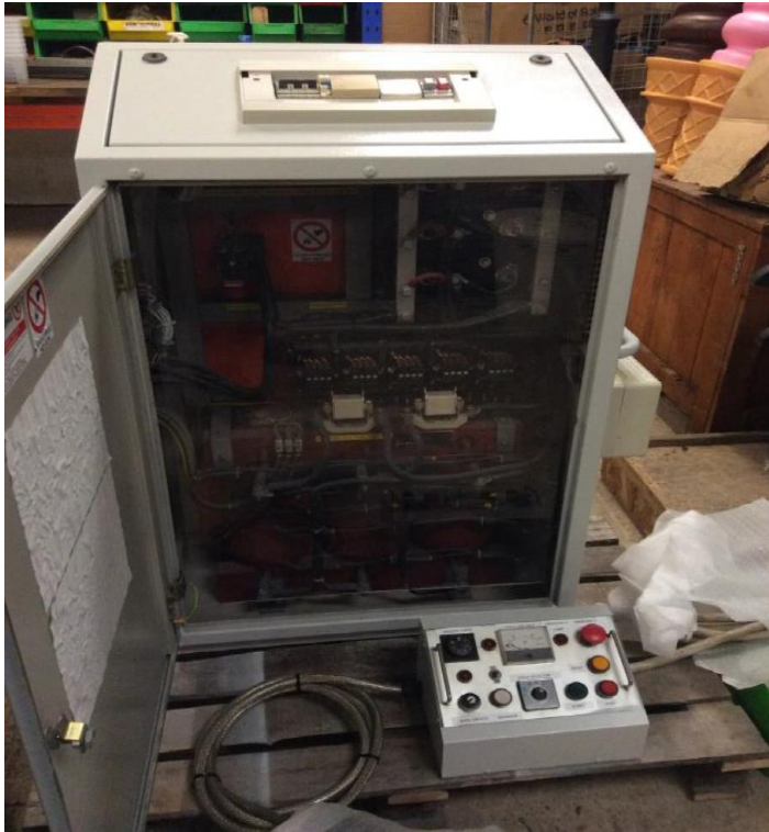
Rectifier control panel
